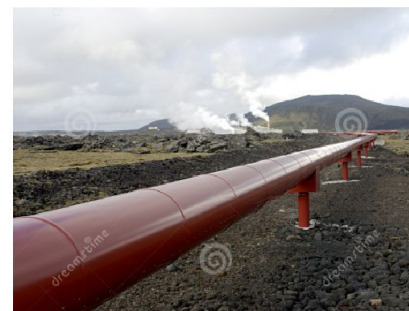
Conduite islandaise permettant le cheminement des eaux chaudes des geysers
